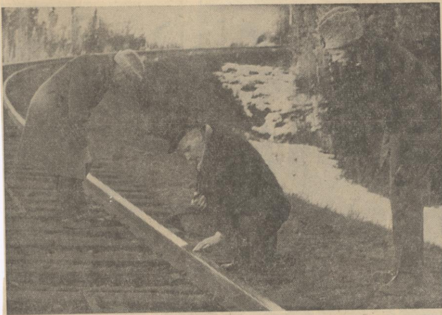
Expertgranskning av stället där hjulet gick sönder. Fr. v. spårtekniker Valdemar Sandgren, Umeå, baningenjör Bengt Lofeldt, Umeå samt banmästare S. Eriksson, Nyåker.
