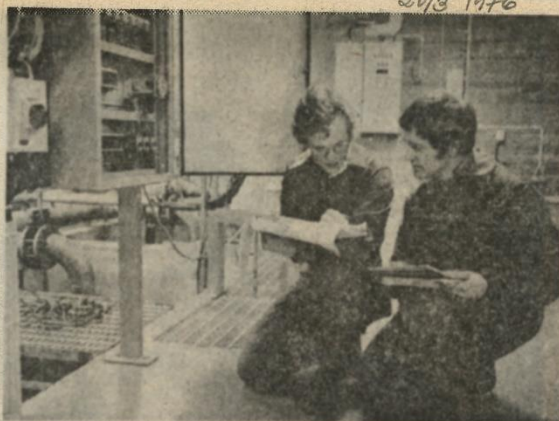
Stig Westman, t v, från Ångpanneföreningen och Olle, Jonsson, VAB, kontrollerar installationer na vid Rundviks nya reningsverk.
