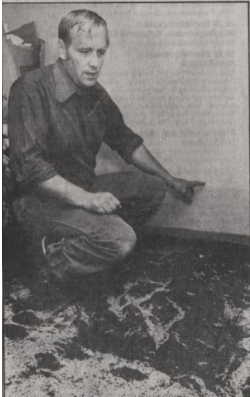
● Lage Eriksson visar hur det såg ut i toalettugan på aftonen den 25 juli. Slam på hela golvet och vattenspår en halvmeter upp efter väggen.
