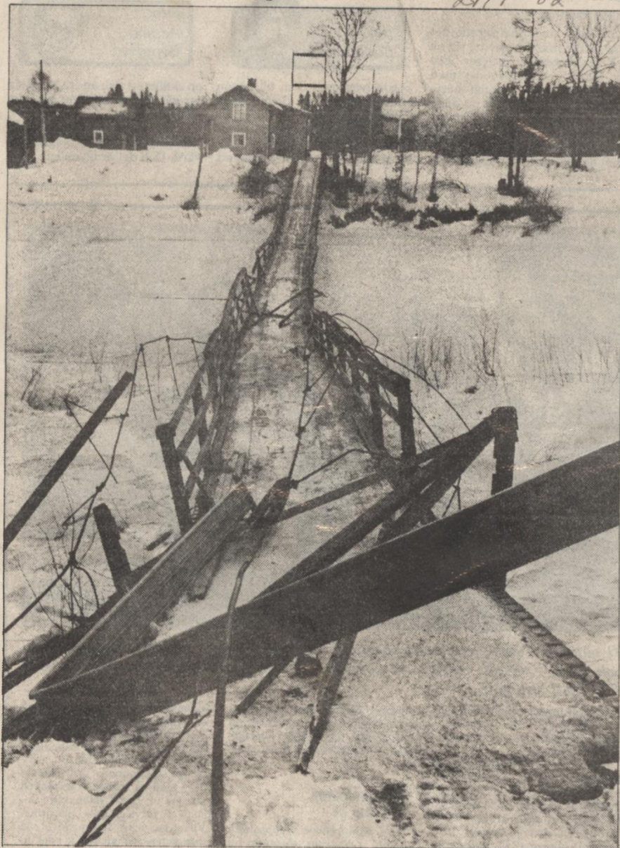
• Den av stormen raserade bron över Öreälven, som är av vital betydelse för de fem familjerna i Hummelholm. Men det kostar mellan 600 000 och 1,2 miljoner att bygga upp en ny.
