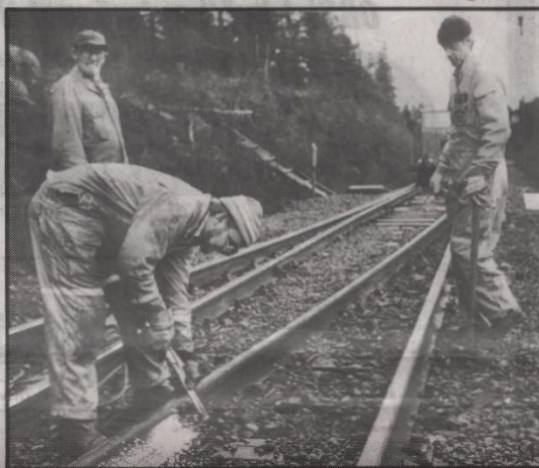
• Omfattande skador uppstod på bl a bultar som håller rälsen vid sidospårsväxlingen till Norrfors. På bilden byts bultarna ut allt eftersom de blir avskurna av Rickard Lindmark, Umeå.
