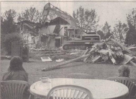
Huset blev totalförstört i branden.
