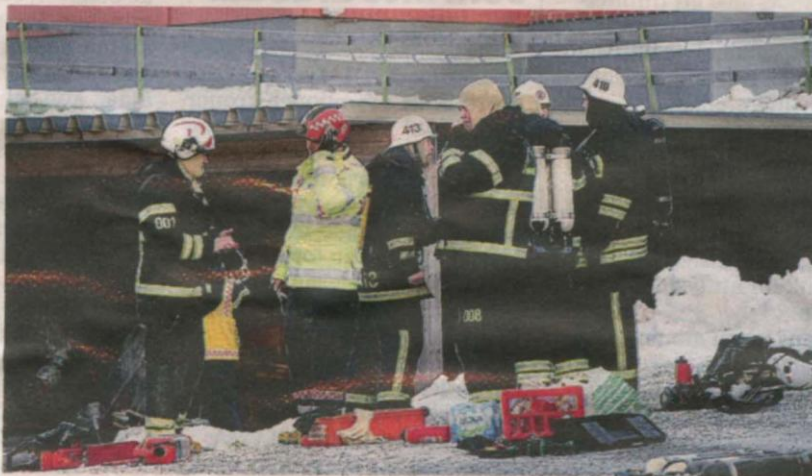
25 brandmän deltog i släckningsarbetet under natten och tisdag morgon. Glödhärdar i bjälklagen ställde till det.
